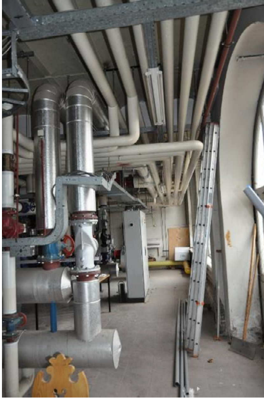
69 Interieur van de ketelruimte in de noordvleugel.
