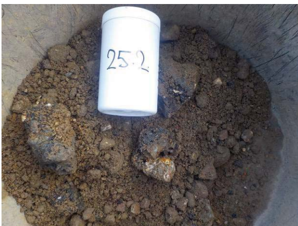
Foto 5: Puinggranulaat met sintels onder de weg. Opm. Boring 25 is boring 23 op tekening.
