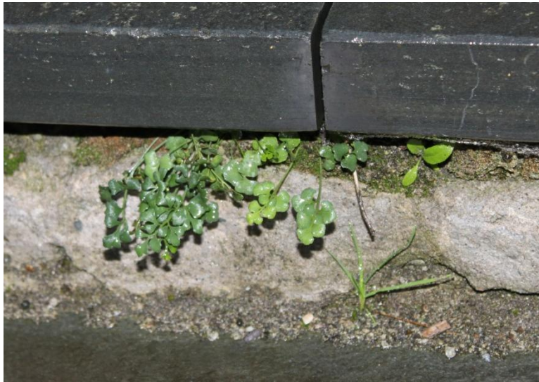
Foto 1: muurvarentje in het trapportaal van het hoofdgebouw
