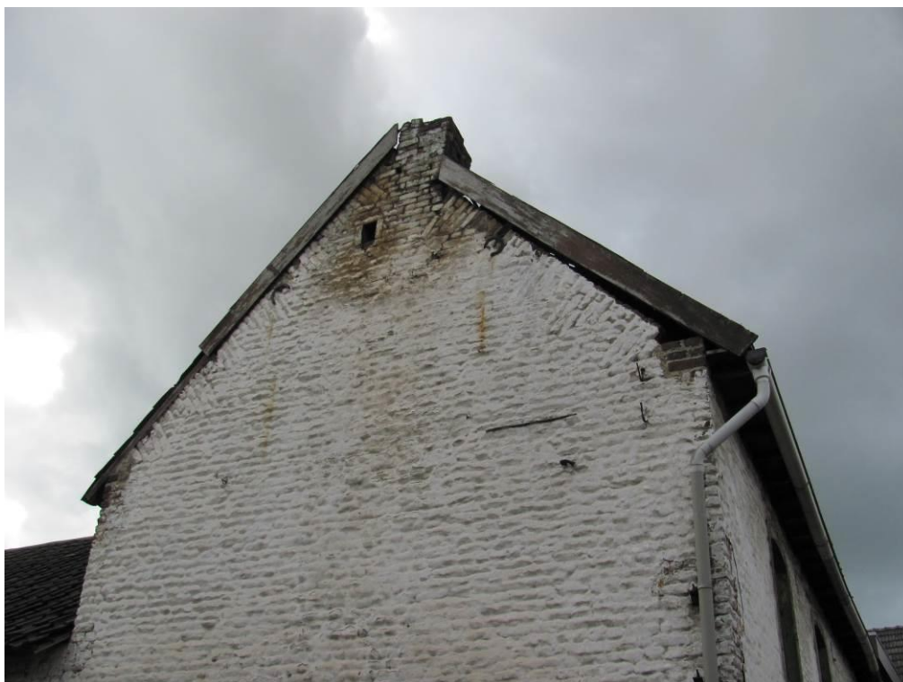
Foto 2: Sterk vervallen voormalige woning
