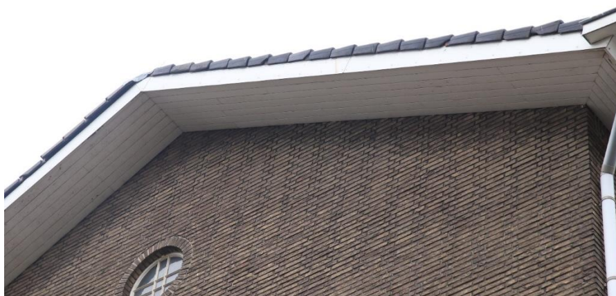
Foto 1: De daken zijn niet geschikt voor gierzwaluwen, huiszwaluwen en huismussen om te broeden. De gevelbeplating is te glad voor gierwaluw (trespa beplating). De witgeverfde onderkant zijn niet in gebruik door huiszwaluwen
