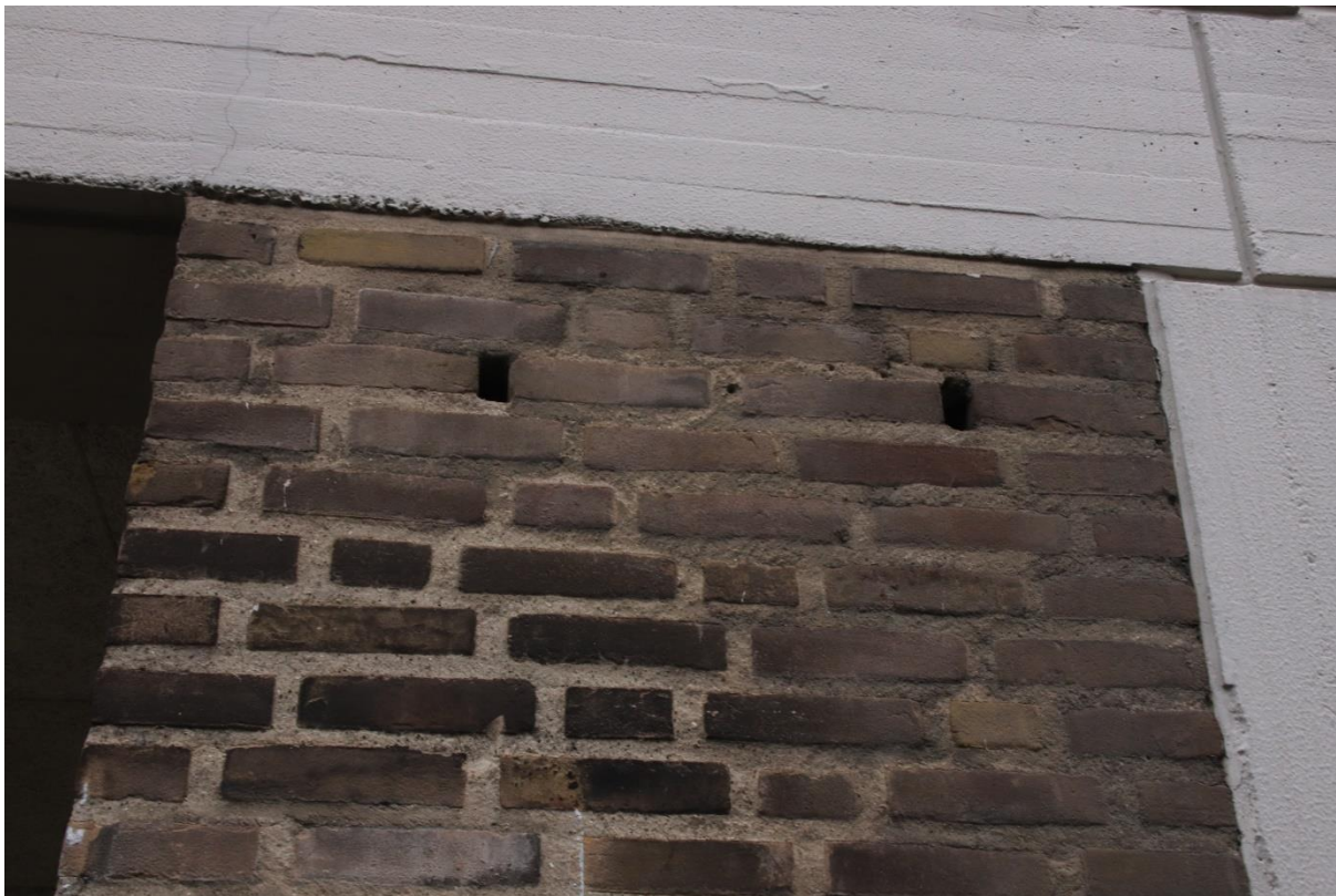
Foto 2: Op meerdere plekken zijn open stootvoegen aanwezig die het voor vleermuizen mogelijk maakt het pand als verblijfplaats te gebruiken
