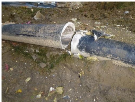
Asbestverdacht materiaal maaiveld
