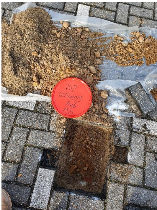
Foto proefgat B16
