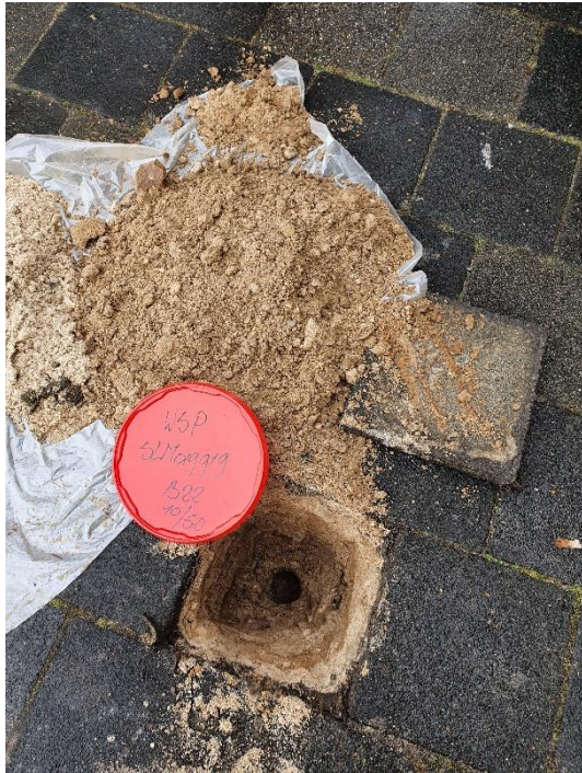
Foto proefgat B22
