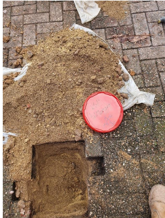
Foto proefgat B04
