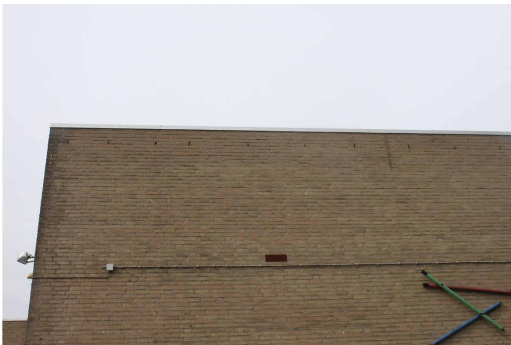
Afbeelding 3: Open stootvoegen geven toegang tot de spouw
