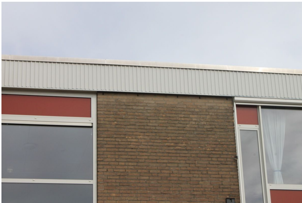
Afbeelding 2: Open stootvoegen geven toegang tot de spouw
