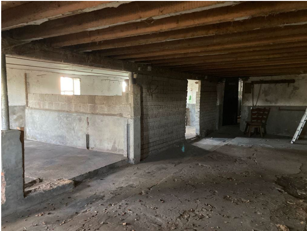
• Afbeelding 15: binnenkant paarden stal is al jaren niet in gebruik
