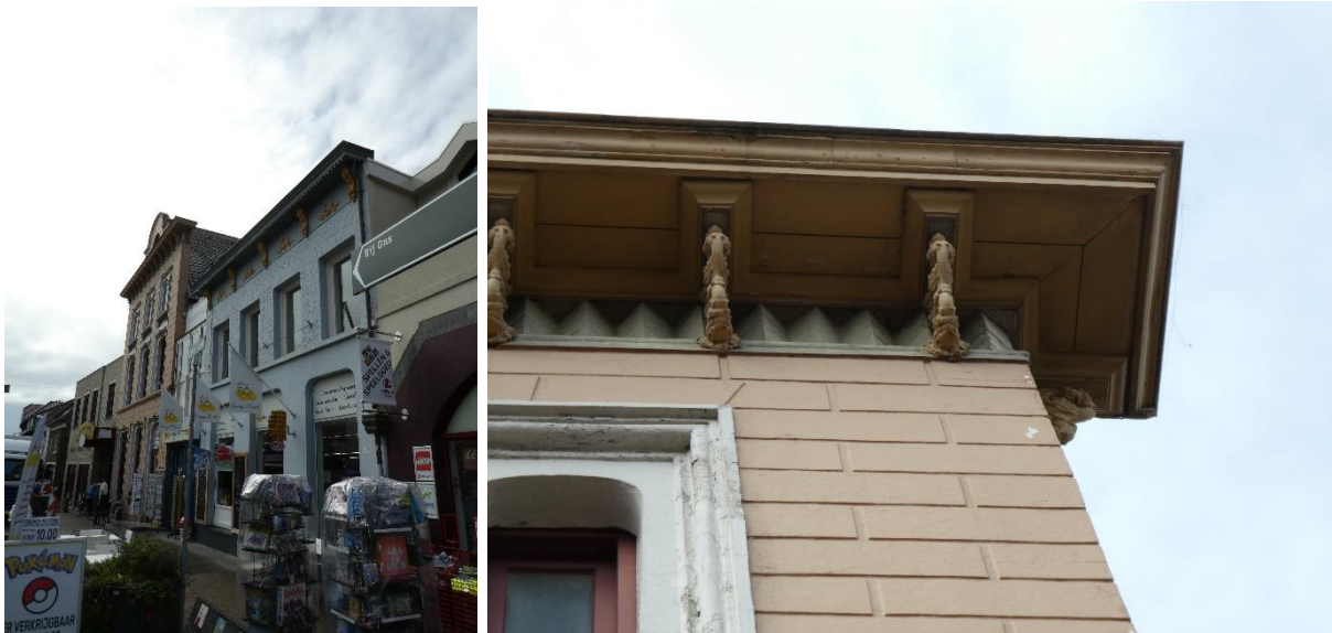
Afbeelding 14 en 15: geen mogelijke nestlocaties/ aanvliegopeningen voor de gierzwaluw aan de straatzijde. Bron: BNL advies, datum: 20-09-2022
