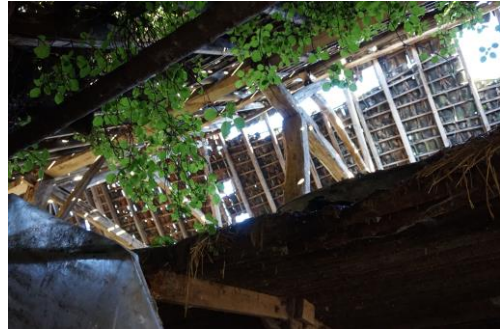
Zicht op interieur, lacunes dakvlak
