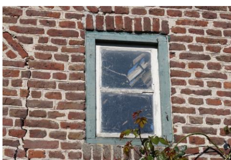
'Slordig' in elkaargezet venster op verdieping
