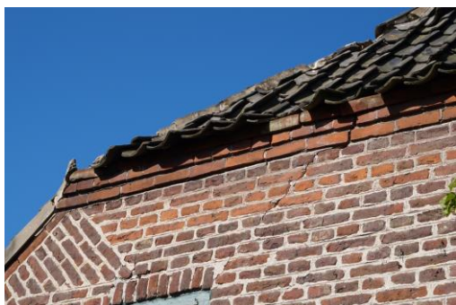
Scheurvorming t.h.v. dakrand
