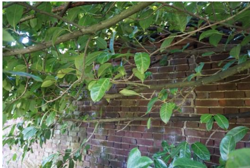
Scheurvorming in uitbouw
