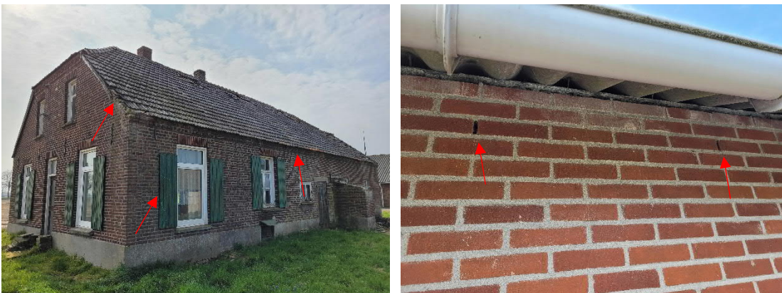
Figuur 3.2 Vervallen woning en schuur op perceel Biezendijk 4 met mogelijke verblijfplaatsen van vleermuizen
