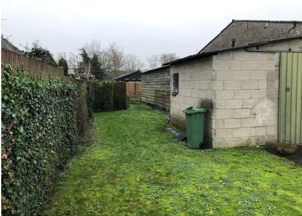
Garage met asbestdak zonder goot
