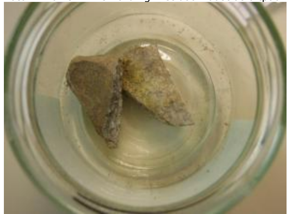
Foto 6: het aangetroffen asbestverdacht materiaal op het maaiveld ter plaatse van proefgat 10.
