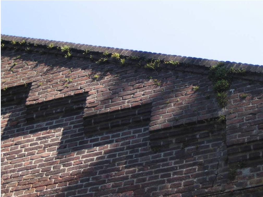
Foto 3: dakrand met muurvarens
