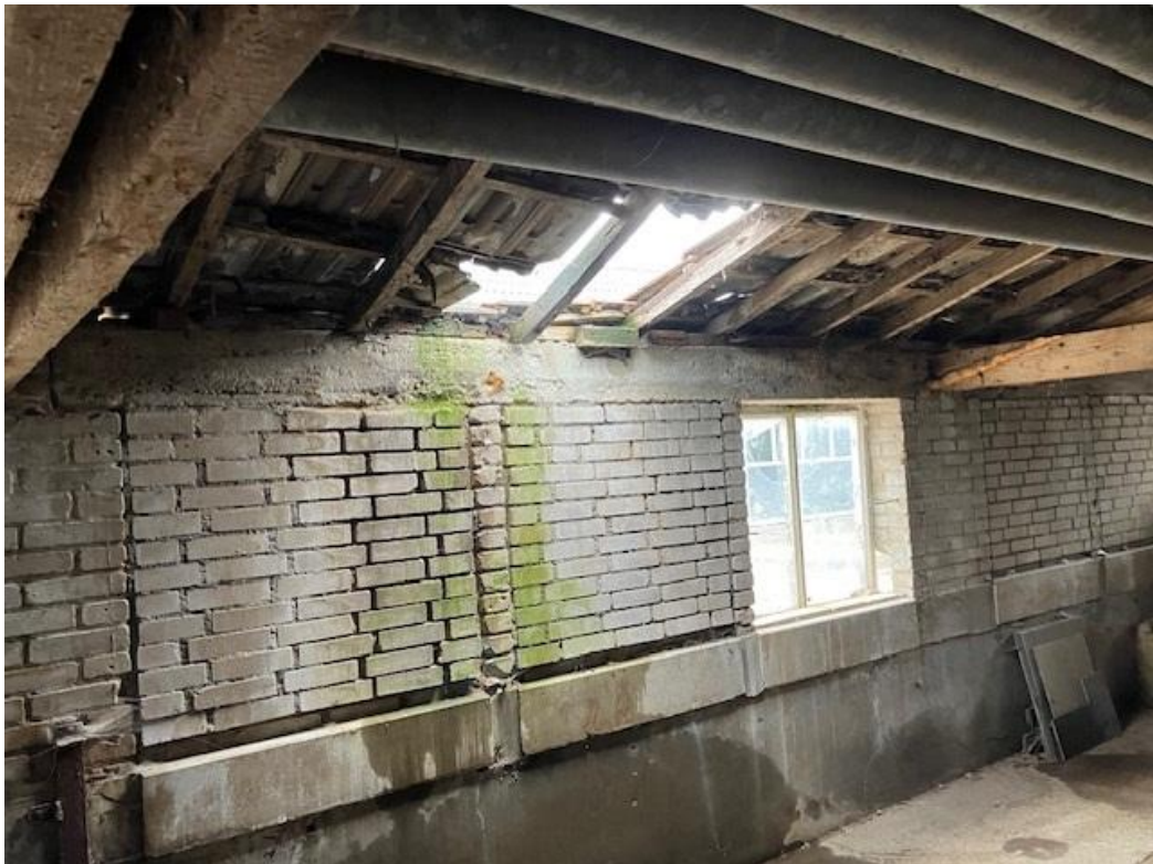
• Afbeelding 8: Overall lekkages en steense muur
