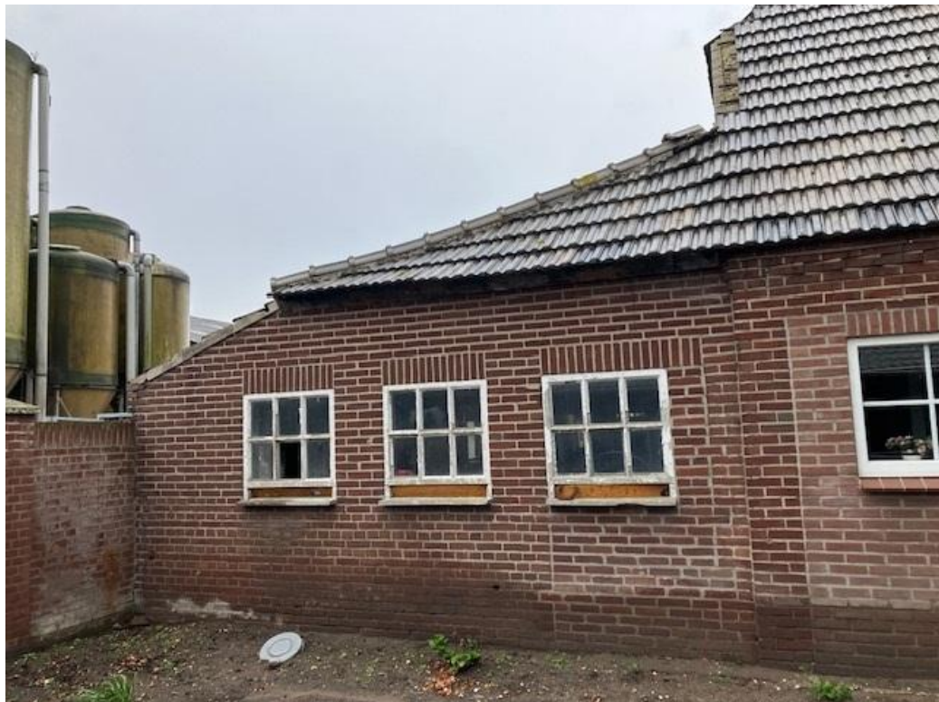
• Afbeelding 4: Het te slopen achterstuk is heel erg slecht
