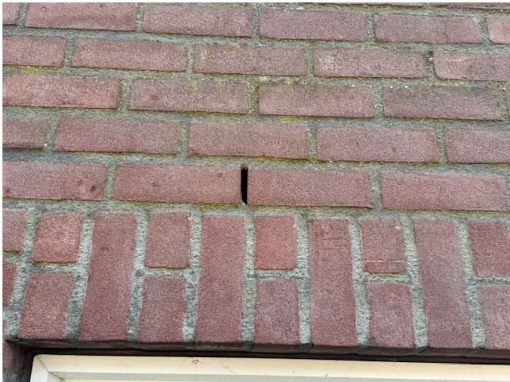
• Afbeelding 5: open stootvoegen in de voorgevel boven lateien
