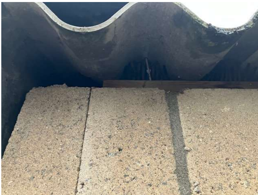
• Afbeelding 18: Onderzijde dak varkensstallen, vogelschroot op de muurplaat
