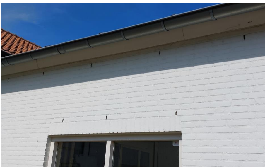
Figuur 4.2.10. Open stootvoegen in de noordgevel van de magazijnruimte.
