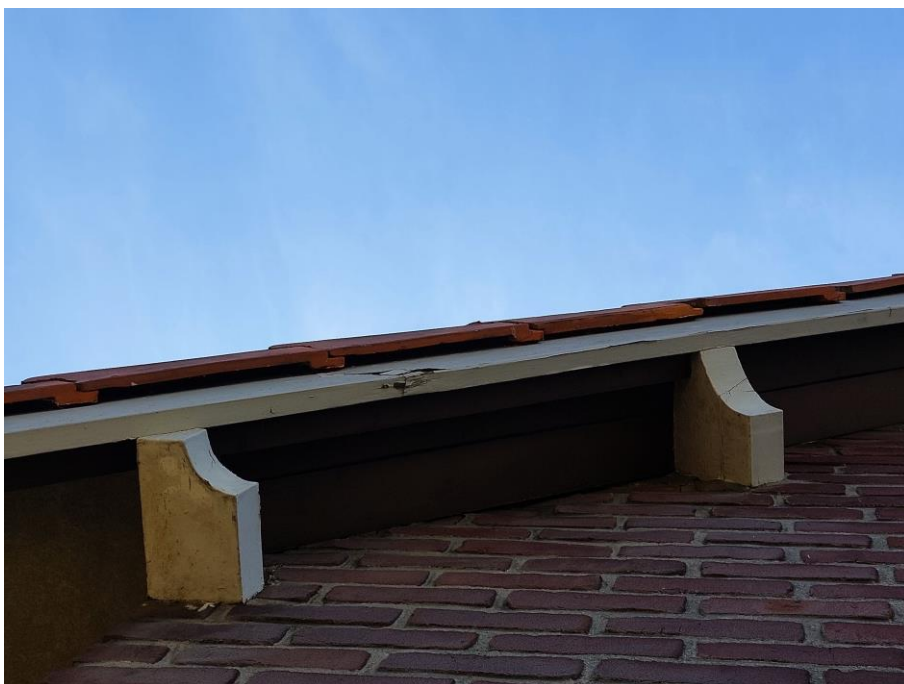
Figuur 4.2.3. Door een opening tussen de gevelpannen en boeiboord kunnen vleermuizen, huismussen en gierzwaluwen de ruimte onder de pannen bereiken.
