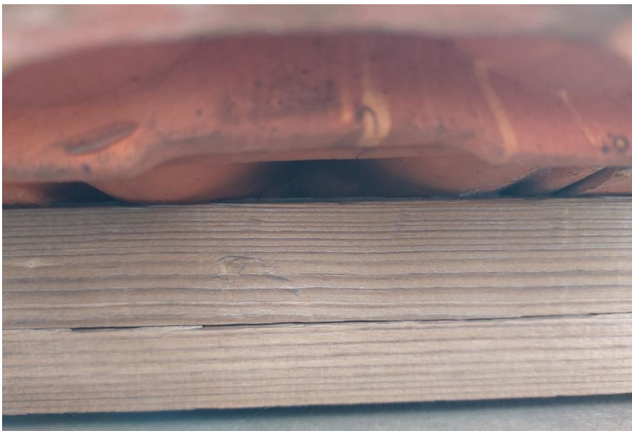
Figuur 4.2.1. De ruimte tussen de pannenlat en dakpannen is voor huismussen en gierzwaluwen te nauw.
