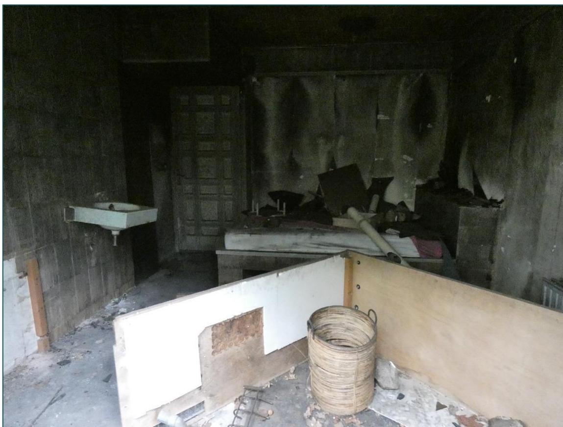
Figuur 2 Een van de kamers van het gebouw, een beeld van de puin, brandschade en achtergebleven meubilair. De foto is van buiten genomen, de ruit mist.
