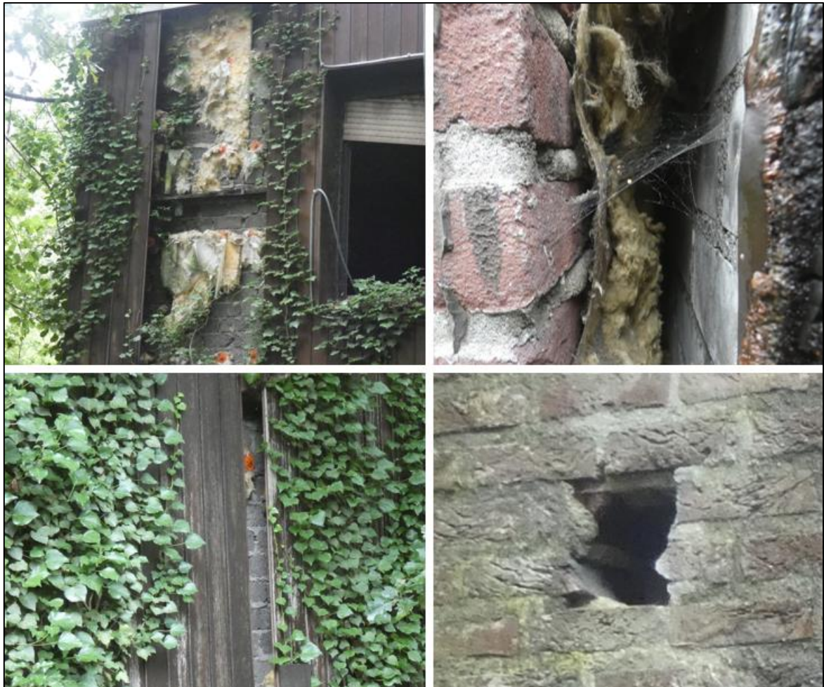
Figuur 3.1 Weggezakke/verbrande isolatie en openingen die vleermuizen toegang geven tot mogelijke verblijfplaatsen.
