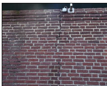
Figuur 14. Een scheur in de muur van het partycentrum.
