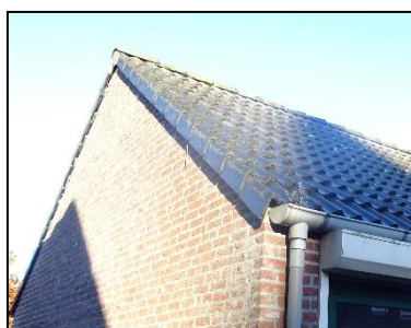
Figuur 21. Overhangende dakpannen bij een van de garageboxen.
