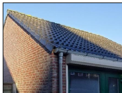
Figuur 13. Dakgoot en overhangende dakpannen bij de bakstenen garagebox.
