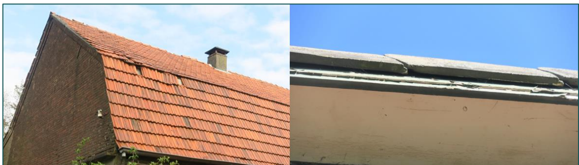
Figuur 3.1 In de bebouwing aan de Bleijenbeek 15 ontbreken dakpannen (links). De kantpannen van de woning aan de Bleijenbeek 17 kieren voldoende om vleermuizen toegang te kunnen verlenen tot de dakruimte (rechts).
