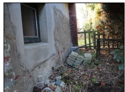
Figuur 8. Bouw- en tuinafval in hoekjes, hier vanaf westzijde.
