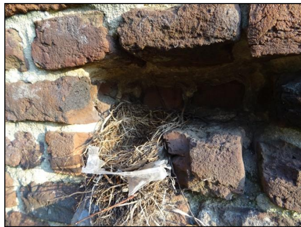
Figuur 11. Bebouwing was in gebruik als nestlocatie.
