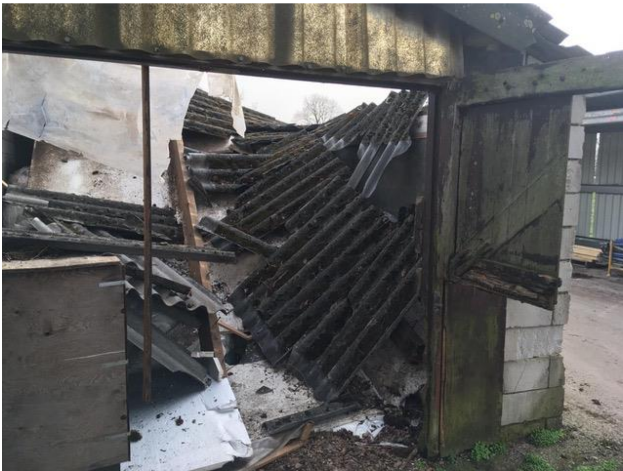
Figuur 3. Het ingestorte dak van de schuur waarin het boerenwaluwnest zat.
