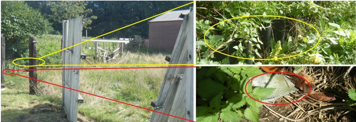
Figuur 2. Locatiefoto terreininspectie waargenomen asbestverdacht (plaat)materialen
