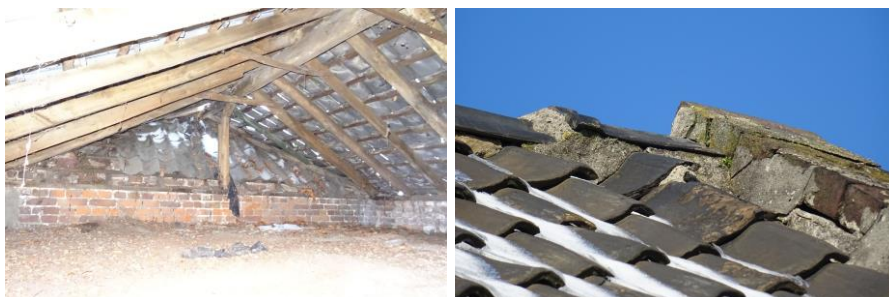
Afbeelding 9 en 10: Dak achterhuis zonder dakbeschot en nokpannen aangesmeerd met cement. Bron: Rik Bijvelds, datum: 12-02-2021
