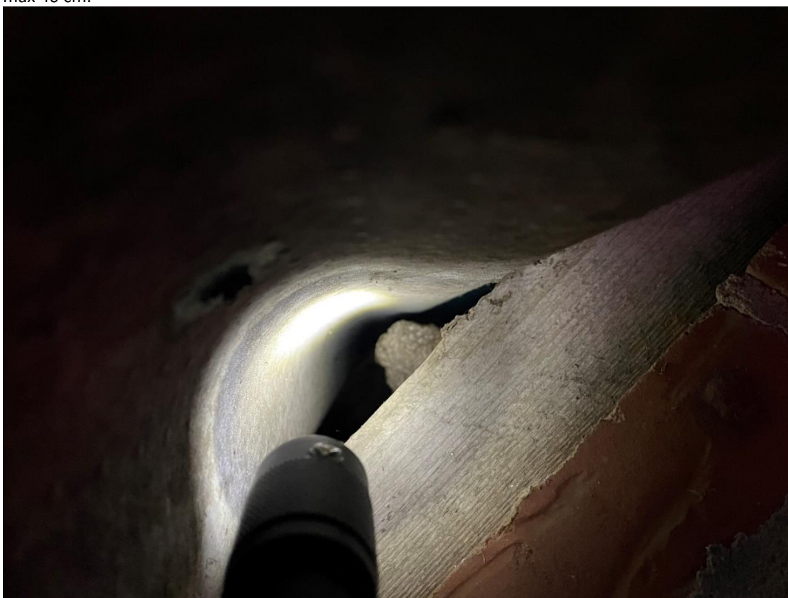
Foto 7: het dak is niet gecementeerd met de gevel van de noordelijke schuur.
