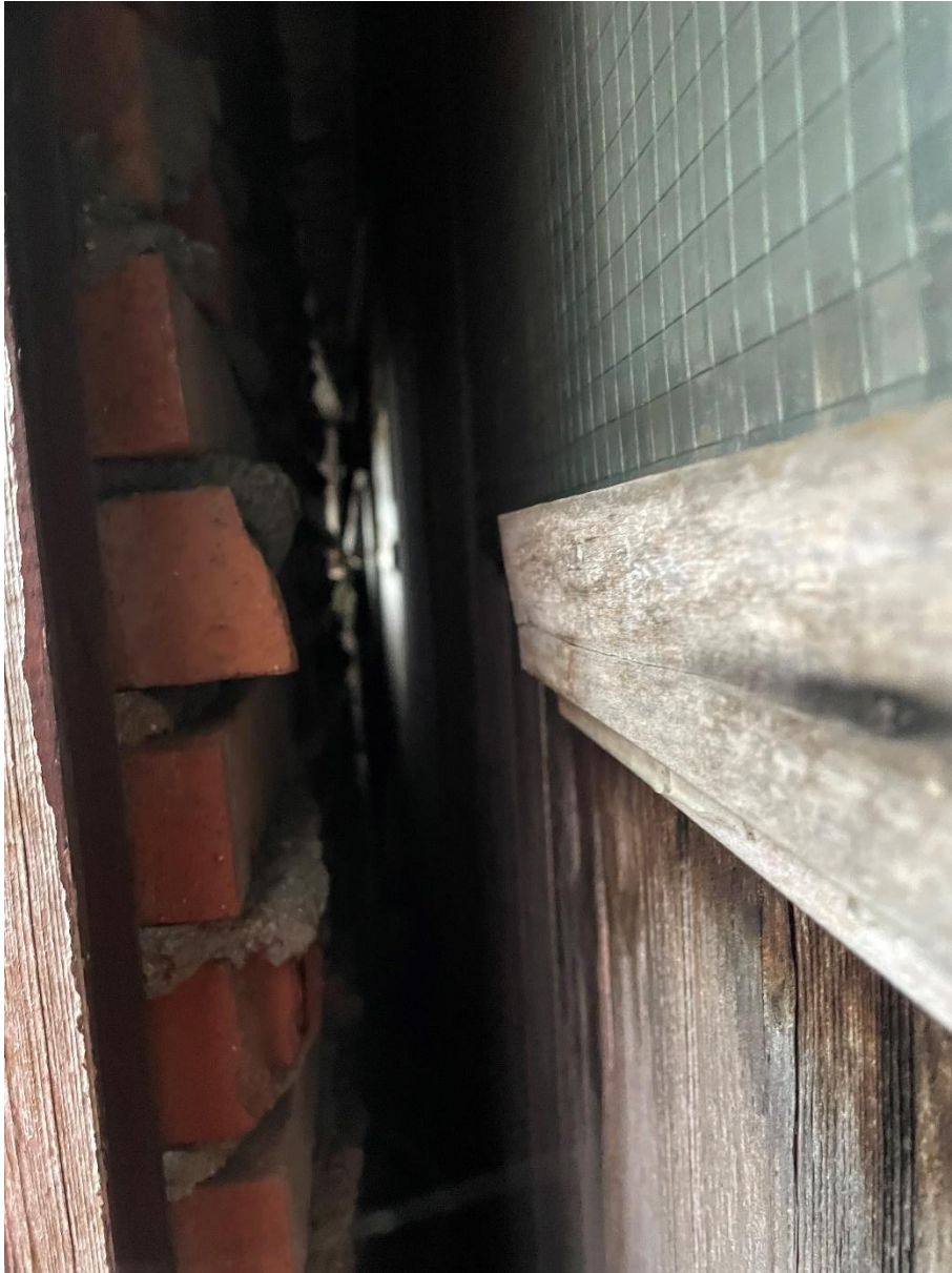
Foto 11: de ruimte tussen de originele wand en de voorzetwand is vrij breed en volledig open waardoor deze bloot wordt gesteld aan weer, wind en licht inval.
