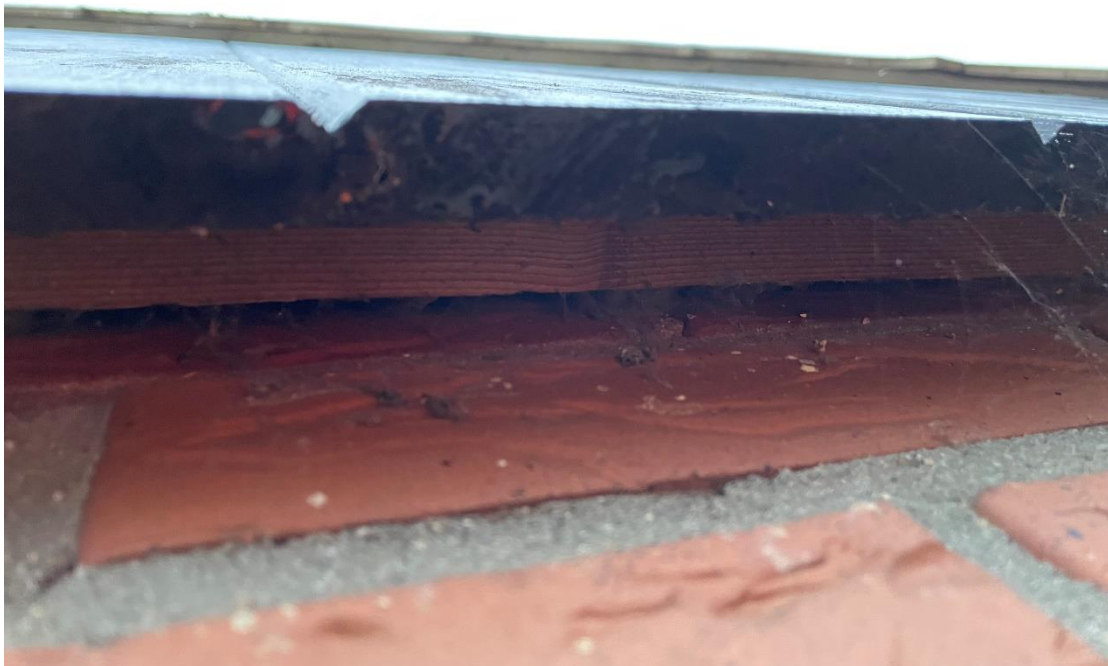
Foto 5: de gevelbekleding van de noordelijke schuur is met een lat afgewerkt waardoor de holte erachter niet bereikbaar is.
