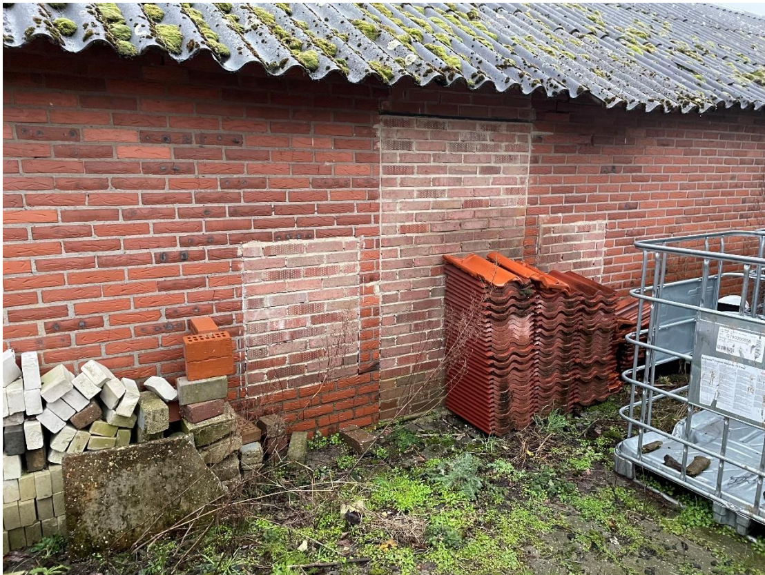
Foto 17: stenen en dakpannen liggen recht gestapeld en bieden hierdoor geen geschikte verblijfplaatsen. Kijkend naar de noordelijke schuur.
