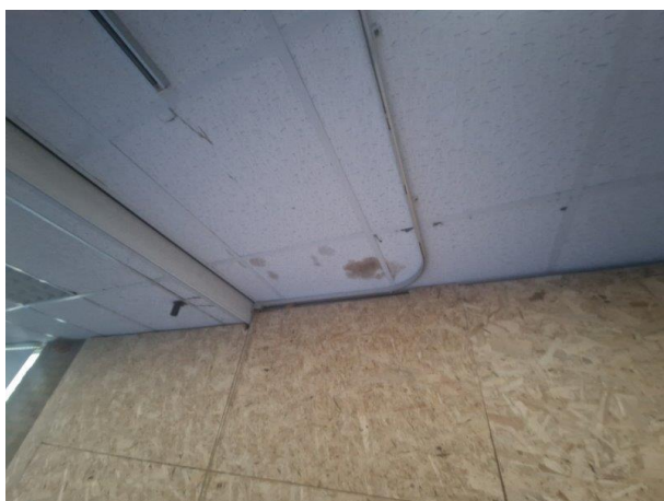
Figuur 5-1. Aangetroffen sporen plafondplaten die duiden op een latrine van de steenmarter.
