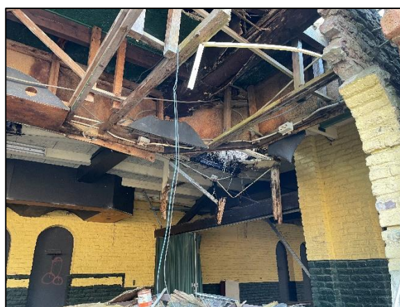
Foto 8. Het noorden van het gebouw, veelal ingestort
