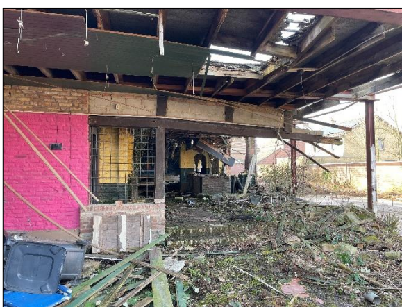
Foto 7. Het noorden van het gebouw, veelal ingestort
