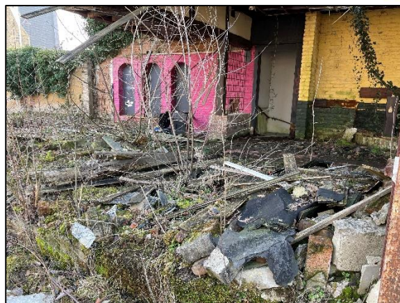
Foto 6. Het noorden van het gebouw, veelal ingestort
