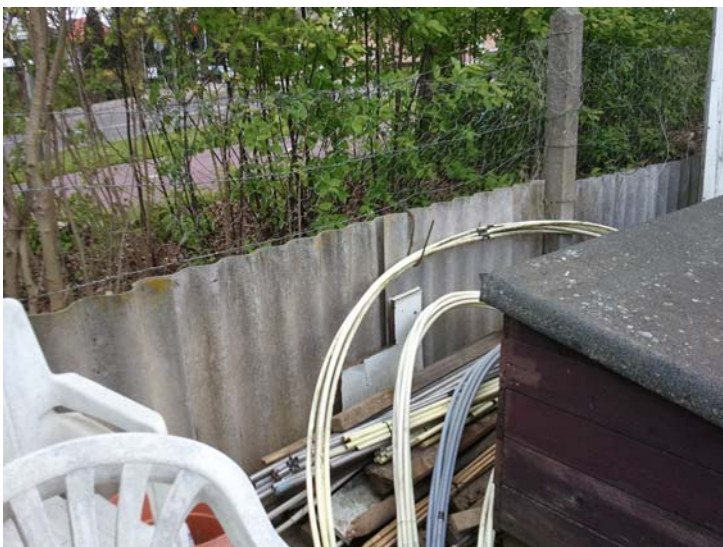
Foto: asbestverdacht plaatmateriaal perceelsgrens Kennedylaan zijde
