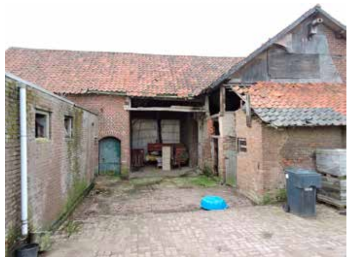
12. Blik op de schuur, richting straat. De poort aan de achterzijde is verdwenen. Links de toegang tot het stalgedeelte
