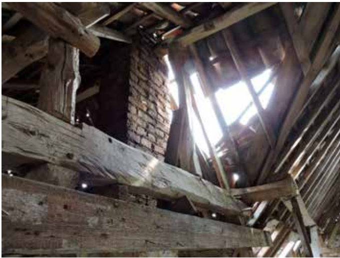
50. Jukdekbalk van het spant bij de dubbele haard als restant van de oorspronkelijke constructie. Ophoging van het dak en vervanging van balken heeft deze uiterst rommelige, constructief zwakke situatie opgeleverd
