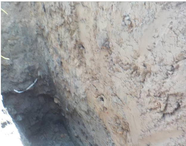
Foto 15: Sleuf 39b met bijmengingen baksteen, afval, asfalt en puin op 0,6-2,0 m-mv.
