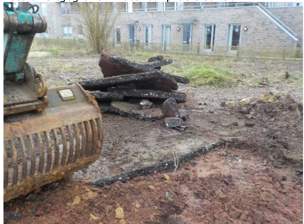
Foto 8. Uitgebroken asfalt proefsleufs 68
