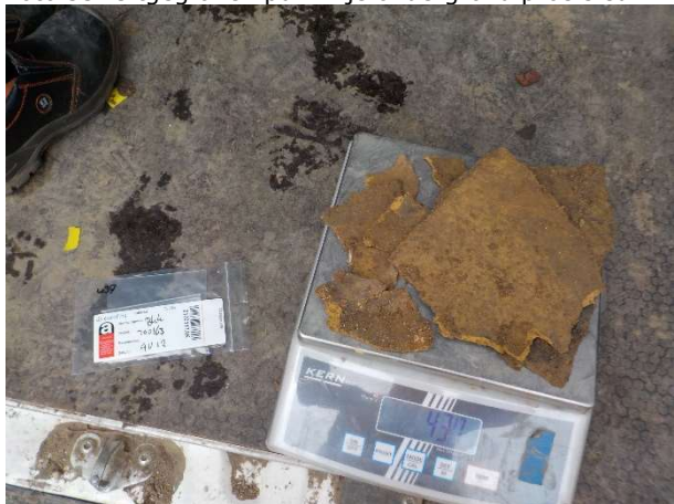
Foto 37. Aangetroffen asbest in proefsleuf 12
