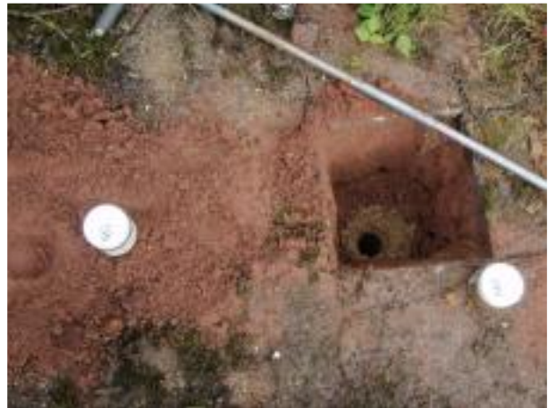
Foto 14: Boring 66 onder voormalige kolenopslag. Baksteenlaag op lemen ondergrond. De 30cm x 30 cm gaten dienen voor funderings/asbest onderzoek.
