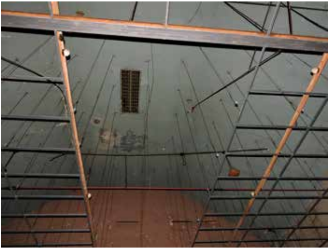
32. Hoog in het plafond zitten op twee plaatsen ontluuchtingsroosters die op zolder uitkomen
