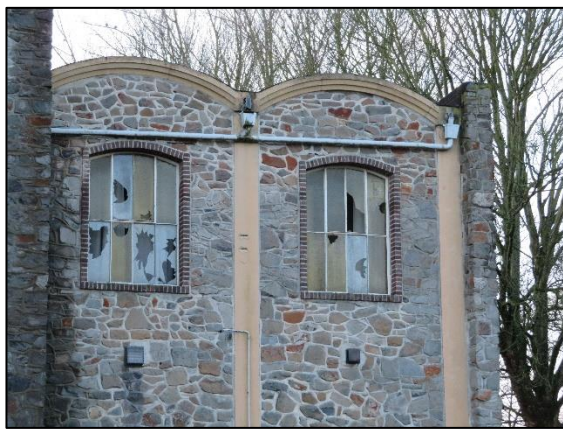
Figuur 9. Ingegooide ruiten waardoor vleermuizen geschikte ruimtes in de bebouwing kunnen bereiken.
