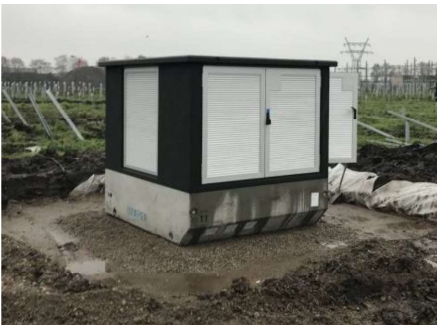
Figuur 8 Transformatorhuisje met fundering. Voor het zonnepark is een uitvoering in Kiezelgrijs voorzien (RAL 7032).
