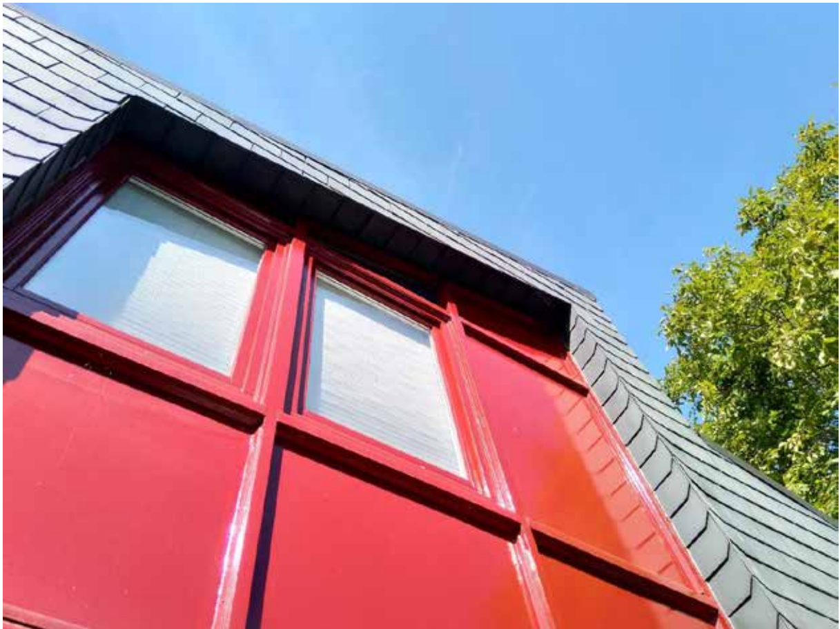
Foto 3: De daktrim welke boven de ramen niet nauw aansluit met de gevelbekleding.
