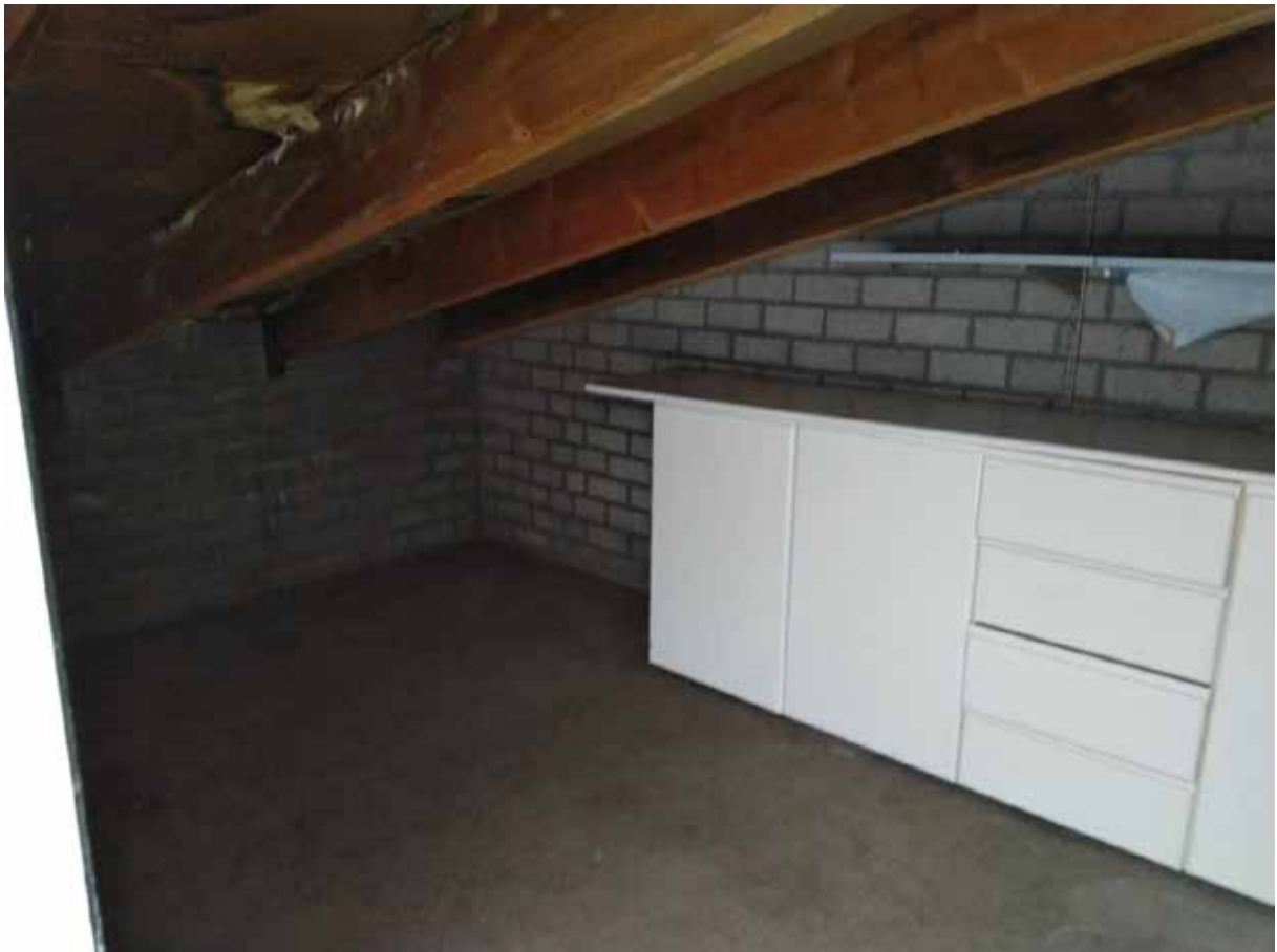
Foto 5: Overzichtsfoto van de zolder aan de westzijde van het woonhuis met schimmelvorming door vocht.
