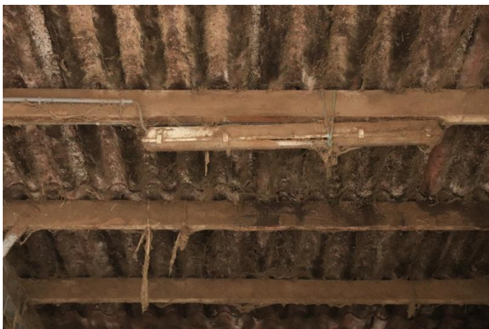
Foto 4: Asbestbeplating en spinnenrag in de stallen
