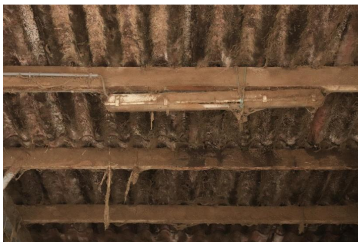
Foto 4: Asbestbeplating en spinnenrag in de stallen
