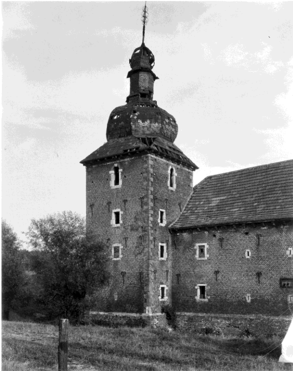
De noordoosttoren van de hoeve in 1953. Goed zichtbaar is de slechte conditie van de spits, die in die tijd de grootste bron van zorg vormt. (Foto: RCE)
