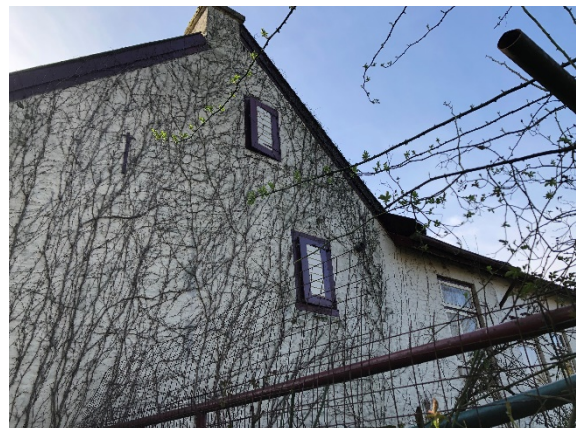
Figuur 13 Noordwestgevel Rimburcherweg 160
