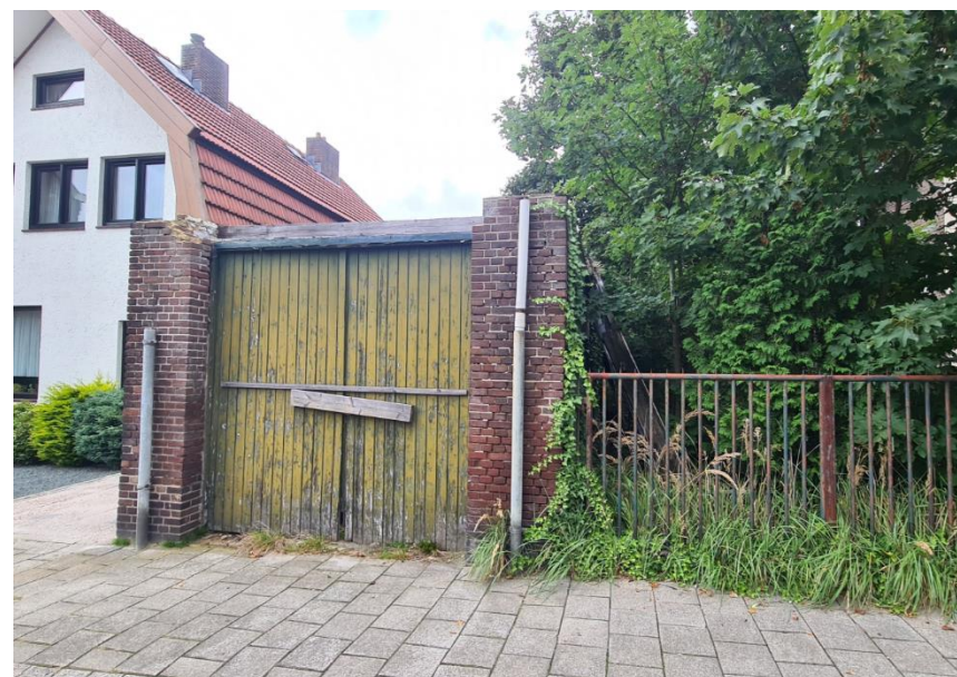
Figuur 7: Vervallen garage tegen de zuidwestelijke erfgrens
