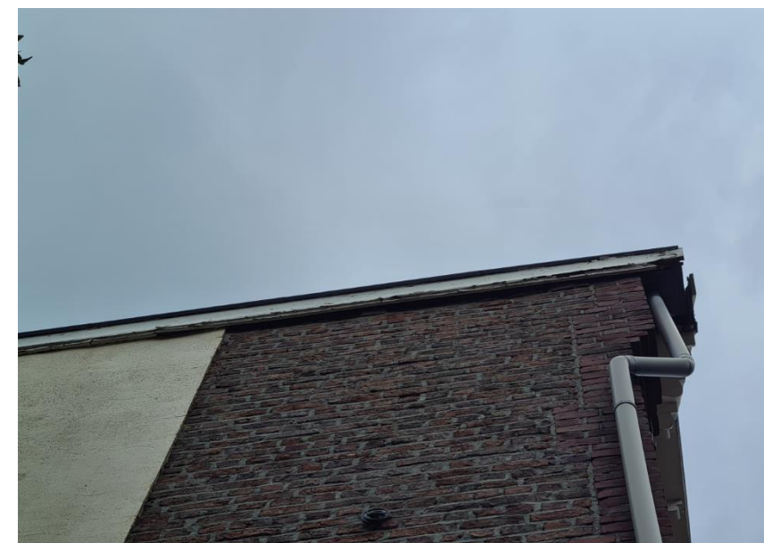
Figuur 8: Kierende dakrand bij de westelijke gevel van het kantoorgebouw
