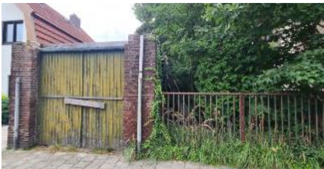
Figuur 7: Vervallen garage in het zuidwesten van het plangebied
