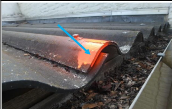
Foto 19 niet asbesthoudende golfplaten afdak tuin
