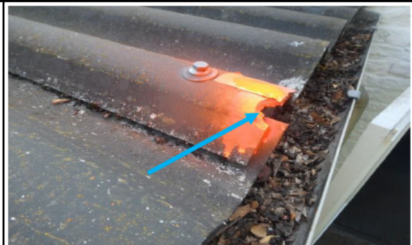
Foto 20 niet asbesthoudende golfplaten afdak tuin
