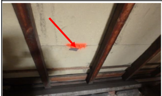
Foto 3 asbesthoudend dakbeschot kantoorpand
