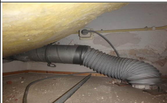
Foto 36 afzuiging toiletten begane grond
