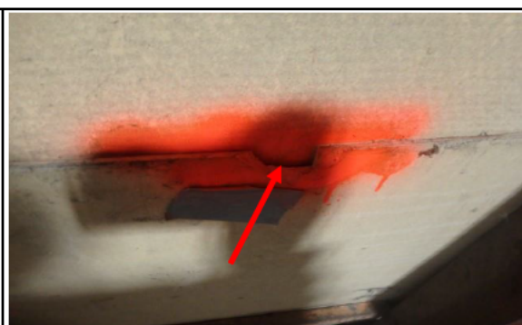
Foto 2 asbesthoudend dakbeschot kantoorpand
