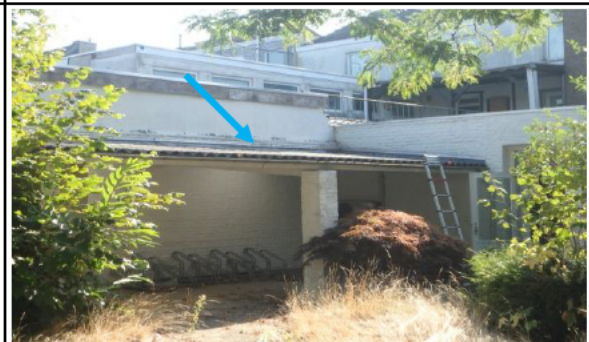
Foto 22 niet asbesthoudende golfplaten afdak tuin
