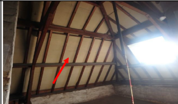
Foto 4 asbesthoudend dakbeschot kantoorpand
