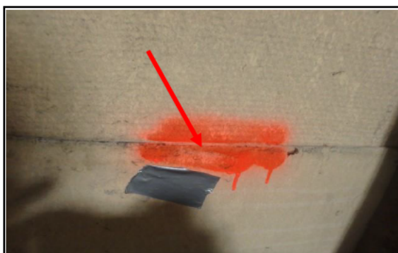
Foto 1 asbesthoudend dakbeschot kantoorpand
