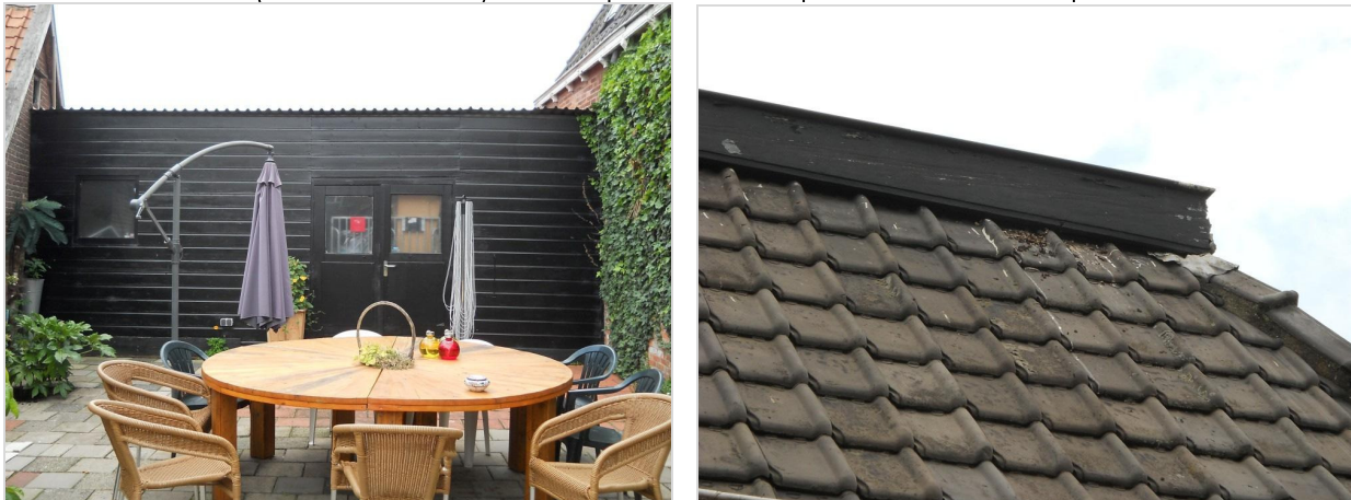
Detailfoto 1 en 2 (nr 4323 en 4336): binnenplaats en dakpannen met uitwerpselen duiven
