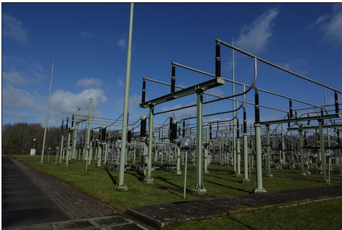
Figuur 4: Op het hoogspanningsstation komen diverse hoogspanningslijnen samen.
