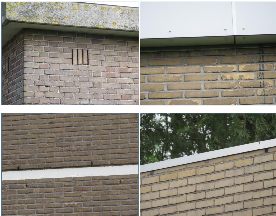
Foto's 2 t/m 5: Open stootvoegen welke toegang kunnen geven tot vleermuisverblijfplaatsen in de flatgebouwen, het elektriciteitshuisje en het tankstation (foto's: R. Top).
