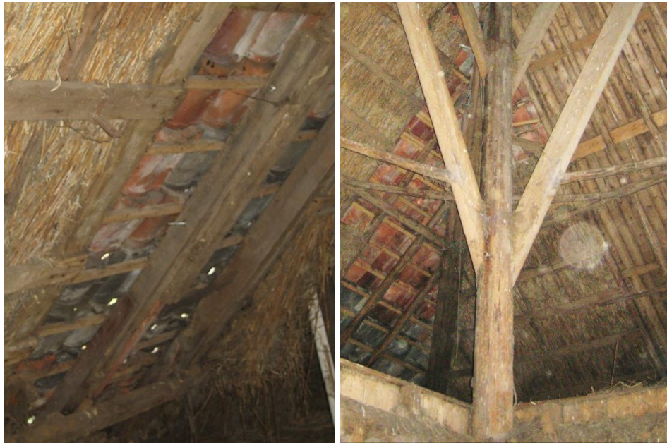
Afbeelding 4: enkele van de vele locaties onder het dak waar isolatiemateriaal of betimmering is verwijderd/vergaan (SAB, 2013).
